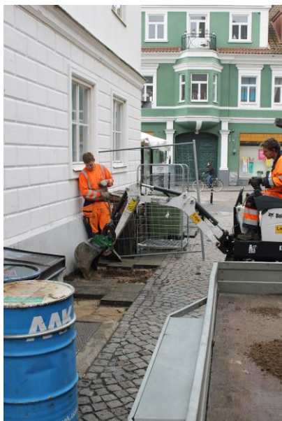
Figur 5. Med hjälp av en Bobcat schaktades det bakom Gamla Rådhuset i Ystad. Foto: Lars Jönsson, Österlenarkeologi.
