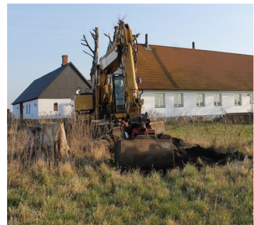
Figur 3. Schaktning för poolen inom fastigheten Hagestad 38:20. Foto mot norr. Foto: Lars Jönsson, Österlenarkeologi.
